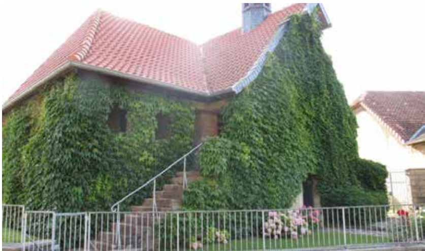
Rückschnitt dringend erforderlich zur Vermeidung von Mauerwerksschäden durch Feuchtigkeit und Durchwurzelung.
