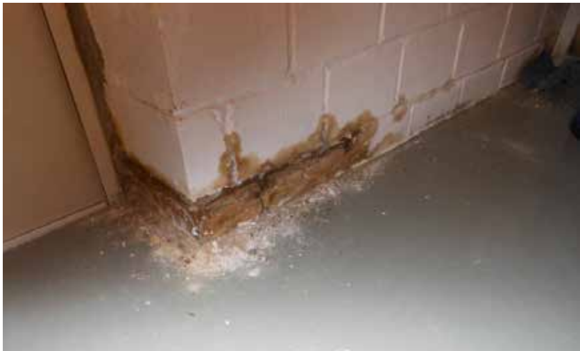
Verfärbungen und Schädigungen am Mauerwerk müssen auf ihre Ursachen untersucht werden.
